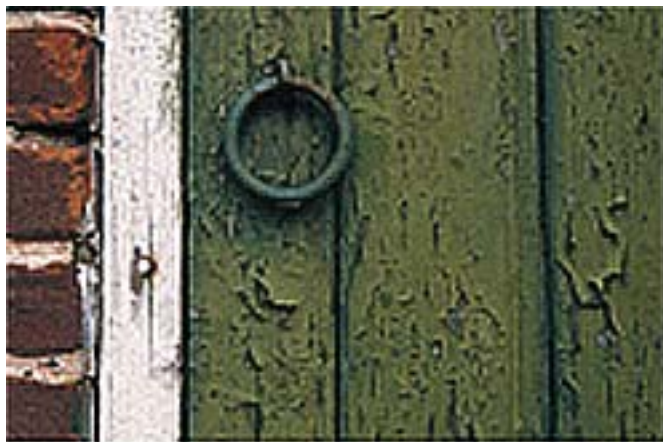
Peeling Door Paint
